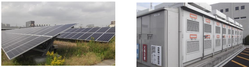
図2 浮間水再生センターの太陽光パネルとNaS電池 出典：筆者撮影
