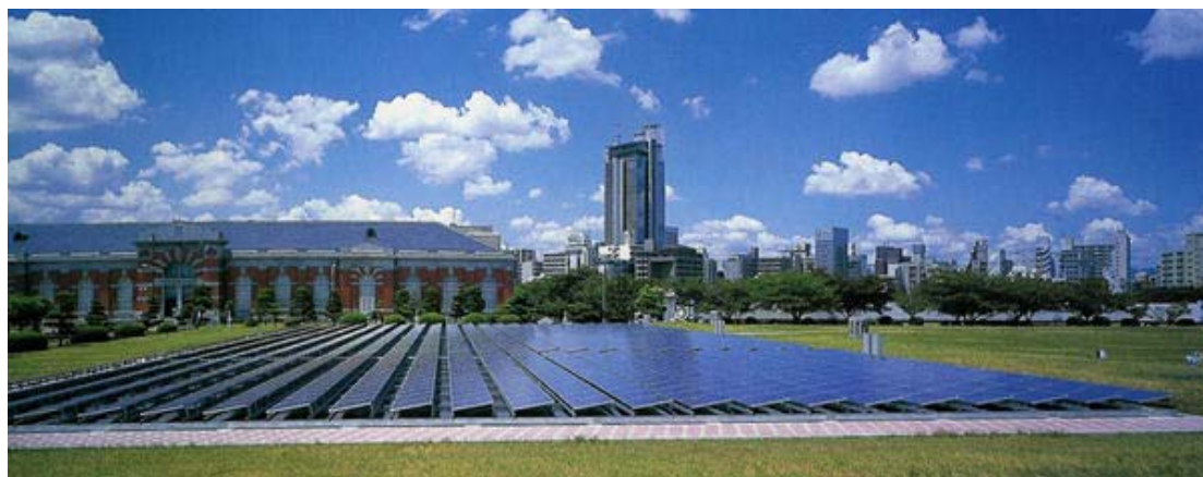
大阪市水道局 柴島浄水場 太陽光発電システム（大阪市水道局HPより） http://www.city.osaka.jp/suido/b_guide/kankyo/taiyoukou.html
